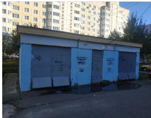
Фотография 3.7. Трансформаторная подстанция
