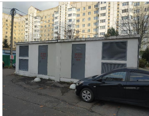
Фотография 3.7. Трансформаторная подстанция
