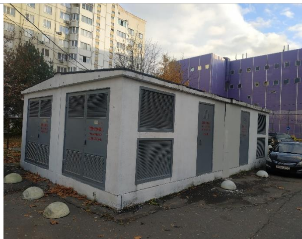
Фотография 3.8. Трансформаторная подстанция
