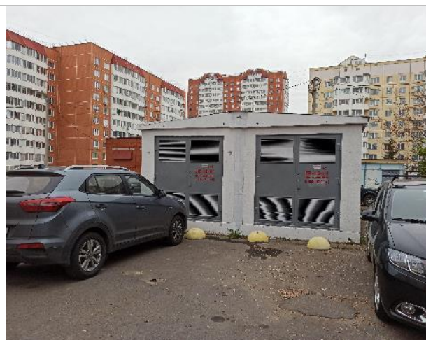
Фотография 3.8. Трансформаторная подстанция (Оцениваемый объект №2)
