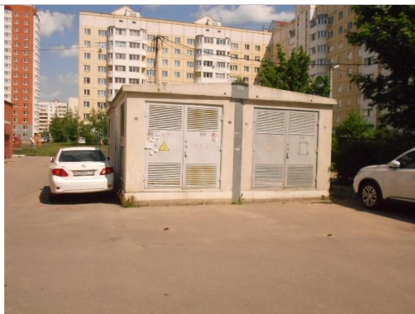
Фотография 3.8. Трансформаторная подстанция (Оцениваемый объект №2)
