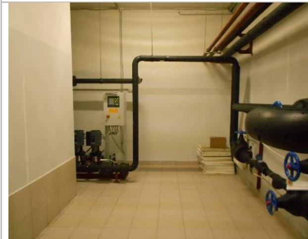
Фото 141. Подз. паркинг и тех. помещения.
