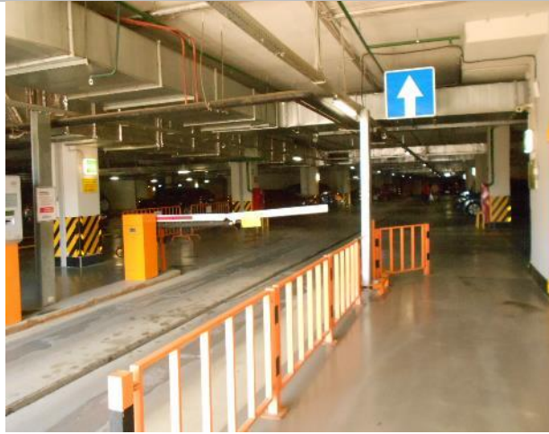
Фото 127. Подз. паркинг и тех. помещения.
