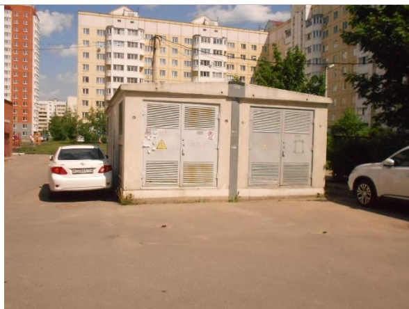
Фотография 3.8. Трансформаторная подстанция (Оцениваемый объект №2)
