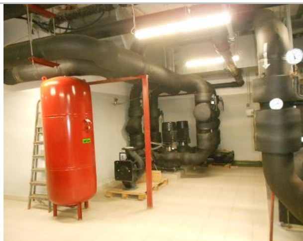
Фото 138. Подз. паркинг и тех. помещения.
