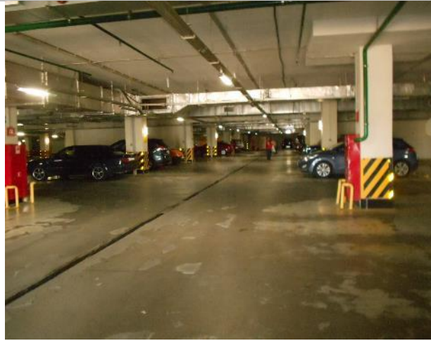
Фото 128. Подз. паркинг и тех. помещения.
