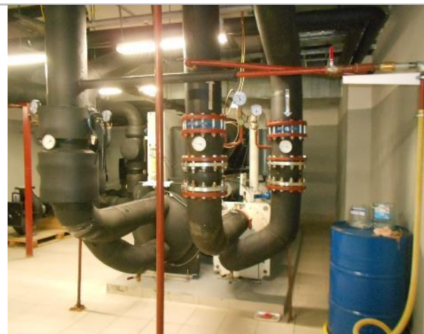
Фото 135. Подз. паркинг и тех. помещения.
