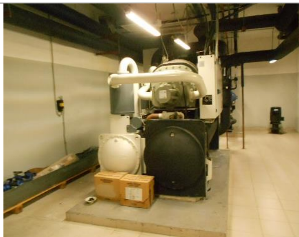
Фото 136. Подз. паркинг и тех. помещения.
