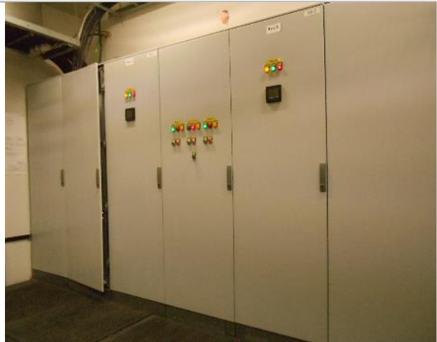
Фото 140. Подз. паркинг и тех. помещения.
