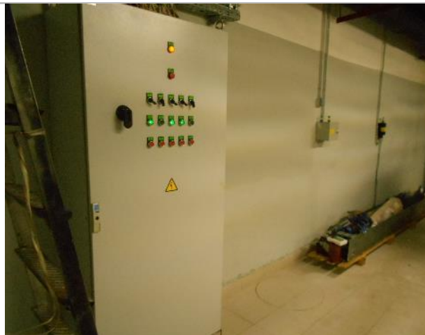
Фото 134. Подз. паркинг и тех. помещения.
