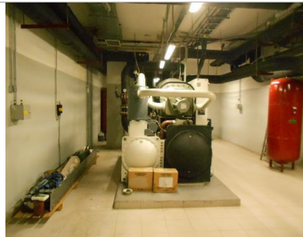
Фото 133. Подз. паркинг и тех. помещения.
